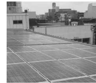
大田センター太陽光パネル
