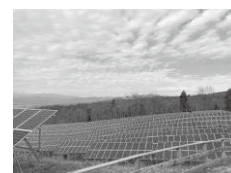
▲太陽光発電(雄国発電所)
