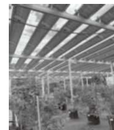
高い位置に設置された ソーラーパネル
